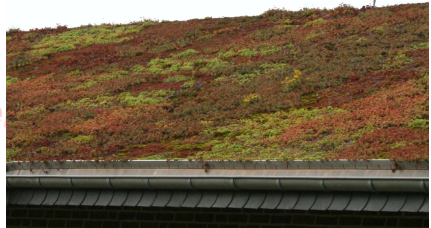
Aus Island sind bewachsene Dächer bekannt. Solch ein Grasdach hat enorme Vorteile: Im Sommer ist es im Stall kühl, im Winter weniger frostig kalt!
